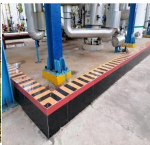
甲醇裂解制氢车间
