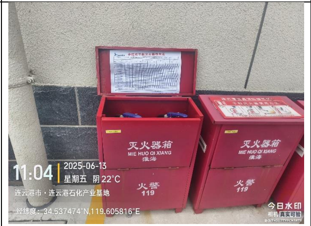
消防器材及检查台账
